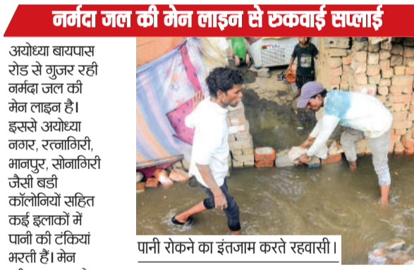
नर्मदा जल की मेन लाइन से छकवाई सप्लाई
